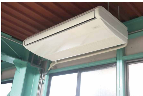
エアコン（第2検品現場）
