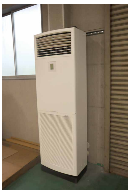
エアコン（第1検品現場）
